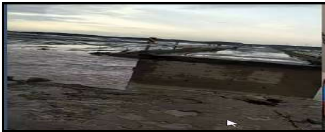
شکل شماره ۱۵: تخریب پل منطقه ماسان جاده گنبد به اینچه برون به دلیل بارش شدید باران و جاری شدن سیل در تاریخ ۱۴۰۲/۰۳/۱۸
