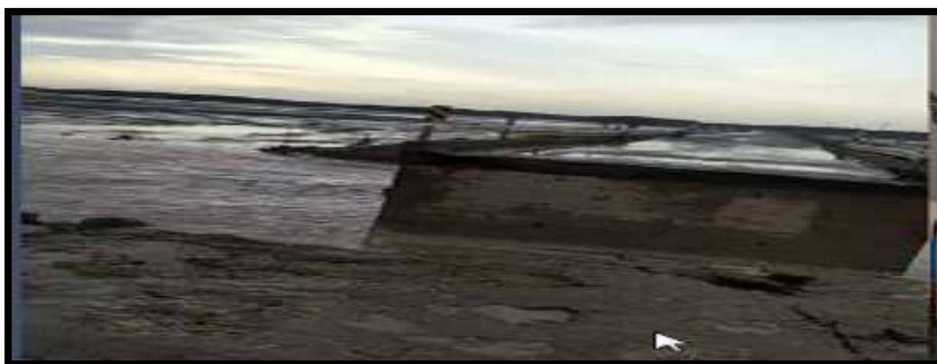
شکل شماره (۲۲): تخریب پل منطقه ماسان جاده گنبد به اینچه برون به دلیل بارش شدید باران و جاری شدن سیل در تاریخ ۱۴۰۲/۰۳/۱۸
