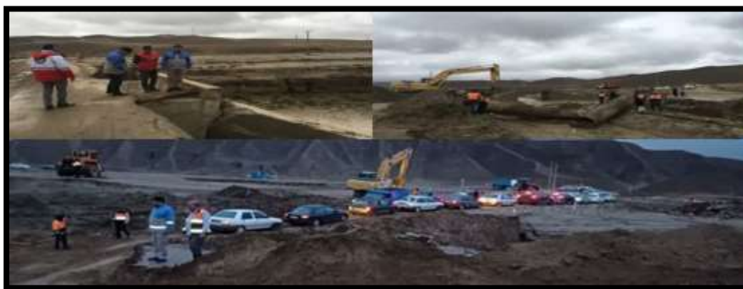
شکل شماره ۲۰: آب گرفتگی و ایجاد خسارت به بخش هایی از پل موقت در روستای اوقچی از توابع شهرستان کلالة در تاریخ ۱۴۰۲/۰۷/۲۰
