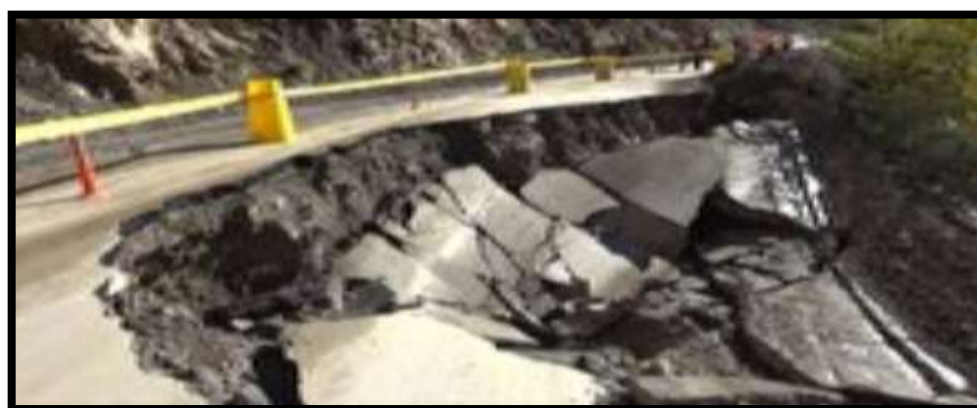
شکل شماره ۲۰: تخریب بخشی از جاده النگ استان گلستان به دلیل وقوع سیلاب در تاریخ ۱۴۰۲/۰۸/۱۶
