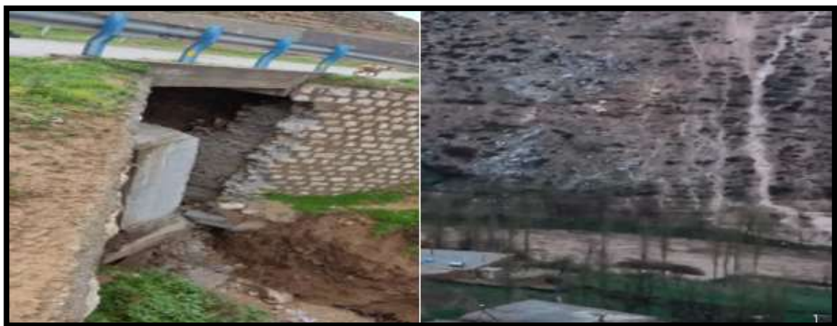
شکل شماره ۸: طغیان رودخانه در روستای نراب و تخریب پل خروجی روستای کاشیدار به سمت نراب در تاریخ ۱۴۰۳/۰۱/۰۷
