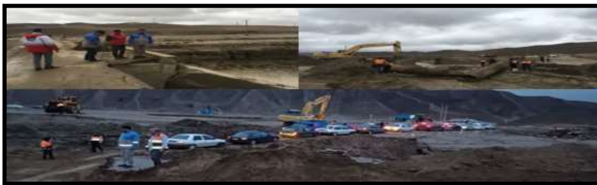
شکل شماره ۳۱: آب گرفتگی و ایجاد خسارت به بخش هایی از پل موقت در روستای اوقچی از توابع شهرستان کلالة در تاریخ ۱۴۰۲/۰۷/۲۰
