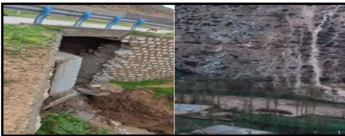
شکل شماره ۴۴: طغیان رودخانه در روستای نراب و تخریب پل خروجی روستای کاشیدار به سمت نراب در تاریخ ۱۴۰۳/۰۱/۰۷
