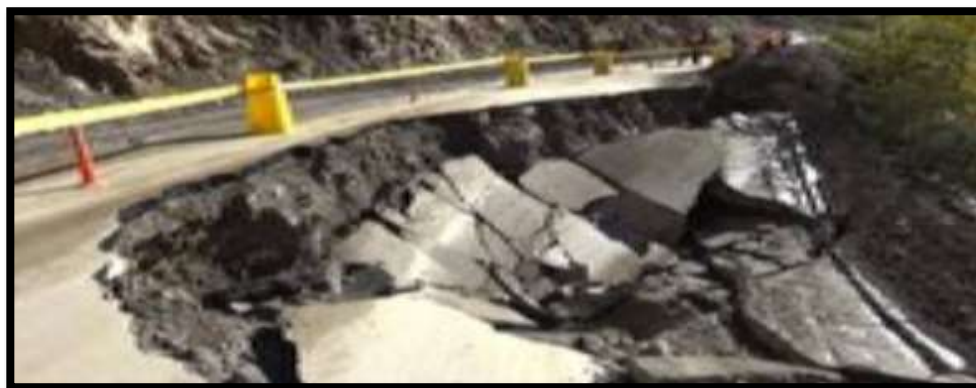
شکل شماره ۳۴: تخریب بخشی از جاده النگ استان گلستان به دلیل وقوع سیلاب در تاریخ ۱۴۰۲/۰۸/۱۶
